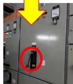
冷水機主電源
