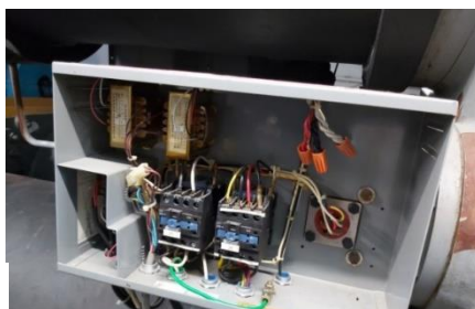
機油加熱器的供電
