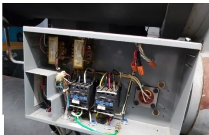
機油加熱器的供電
