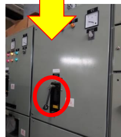
冷水機主電源
