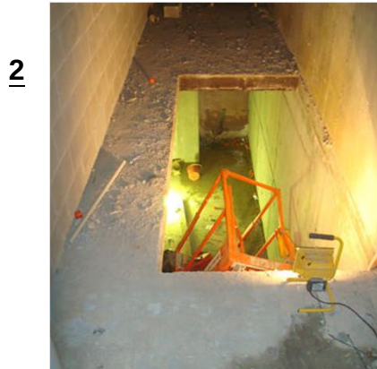
高架升降台墜落的位置
