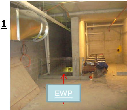
意外後，建築商於照明不足之意外位置豎立圍欄
