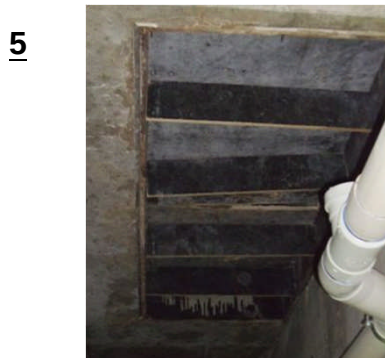
作為洞穴覆蓋之蓋板並非作負荷重之由結構性設計
