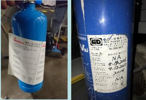
工地發現已過期的滅火器
