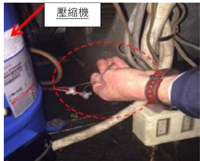
圖三：工人為壓縮機發熱線接駁電線時觸電
