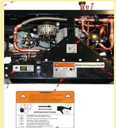
圖二：機件旁已附上警告標示
