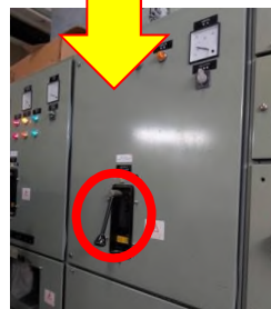
冷水機主電源
